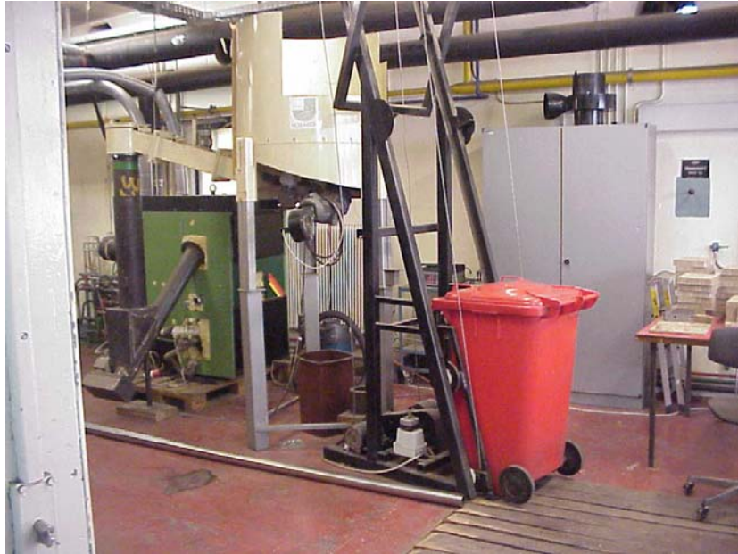
Abbildung II: Regelung-Versuchsstand. Man erkennt links neben der Bildmitte (erhöht) den zylindrischen Brennstoffvorratsbehälter mit dem Aufzug für dessen Beschickung. Links unten neben dem Brennstoffvorratsbehälter ist die Versuchsfeuerungsanlage mit der schrägen Brennstoffzuführungsschnecke zu erkennen.
