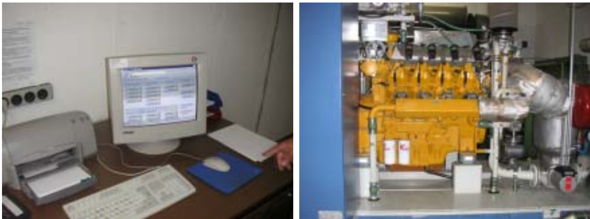
Abb. E10: Leittechnik und BHKW der HEW Contract
