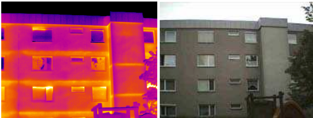
Abb. 63 Wohnanlage Weinheberstr. 3-9 vor der Sanierung. (Bericht WAG_Aussen_Rep1, Seite 15)
