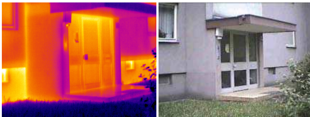
Abb. 60 Thermografie Fassade Nord Kellermauerwerk; Foto Fassade Nord Kellermauerwerk
