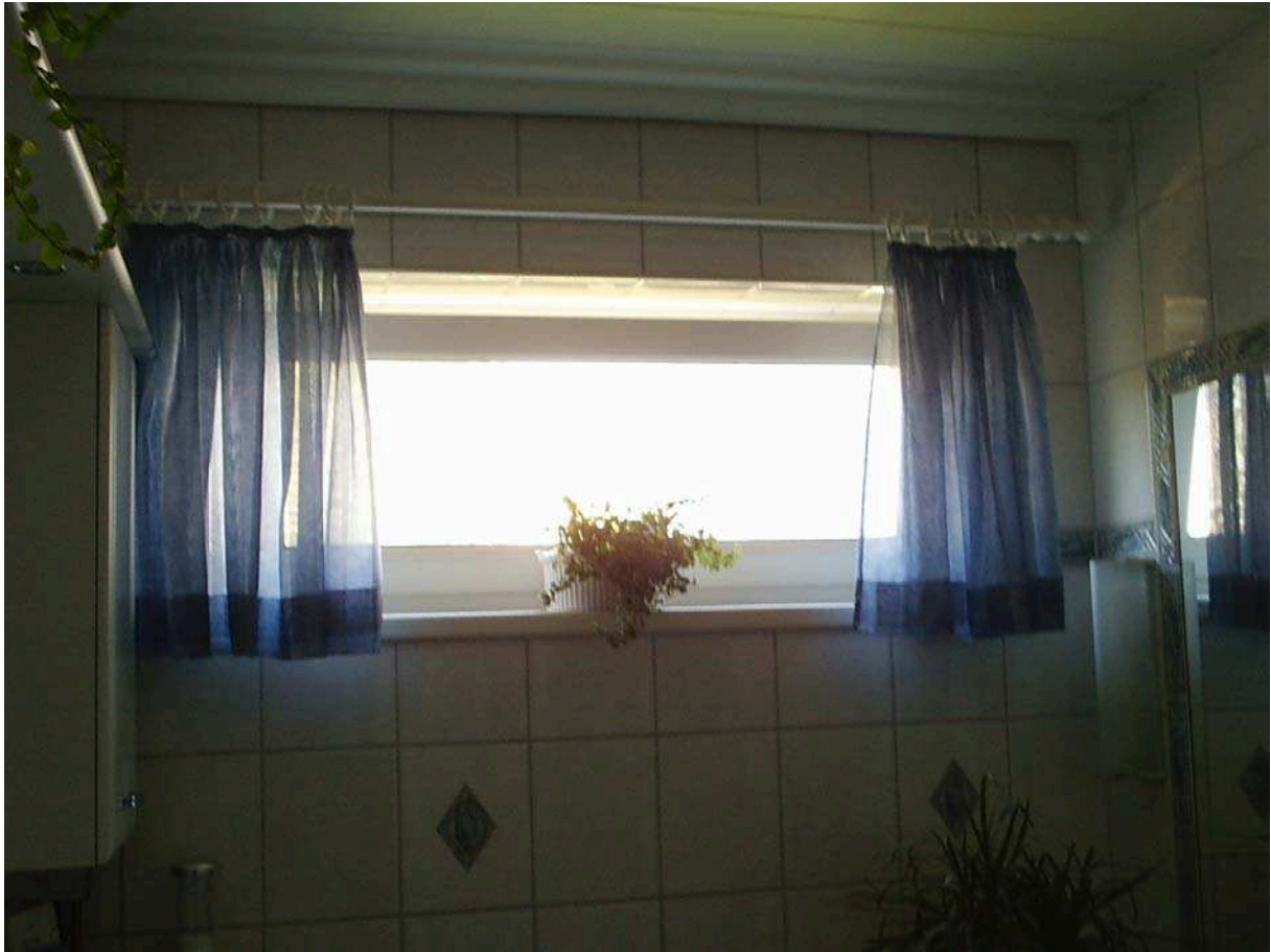
Abb. 52 Innenaufnahme AW Badezimmer – „Gerätemontage schwierig“
