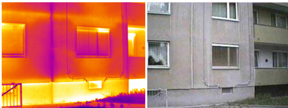
Abb. 61 Thermografie Fassade Nord Gebäudetrennfuge; Foto Fassade Nord Gebäudetrennfuge
