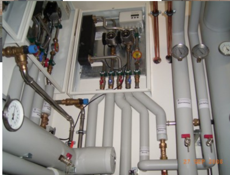
FWS-Perfekt-Kaskade für eine Sportanlage
