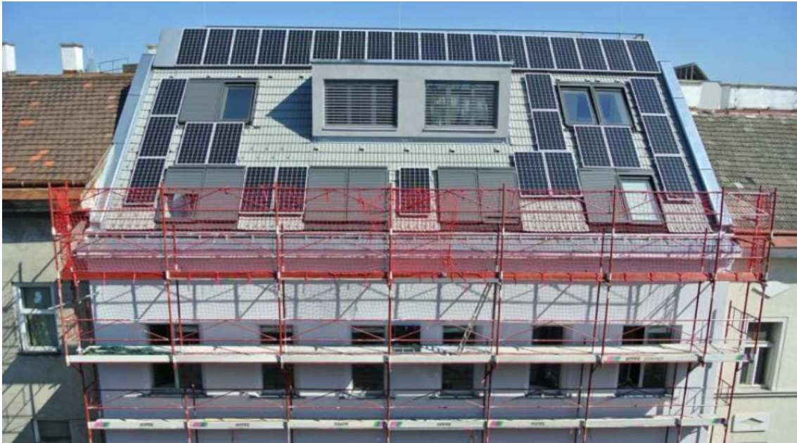
Abbildung 22: Photovoltaikanlage am Dach. Quelle: Andreas Kronberger
