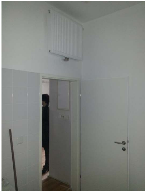
Abbildung 19 Heizkörper über einer Innentüre. Quelle: Schöberl & Pöll GmbH
