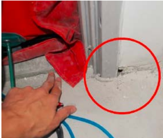
Abbildung 16: Eberlgasse, Lufteintritt im Bereich der Türzarge (Quelle: Ingenieurbüro Filos)
