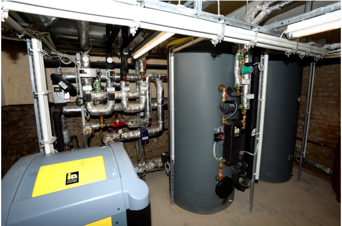
Abbildung 18: Blick in den Haustechnikraum mit Wärmepumpe, Heizungs-Pufferspeicher und Brauchwarmwasserspeicher sowie Verteilung Quelle: Andreas Kronberger
