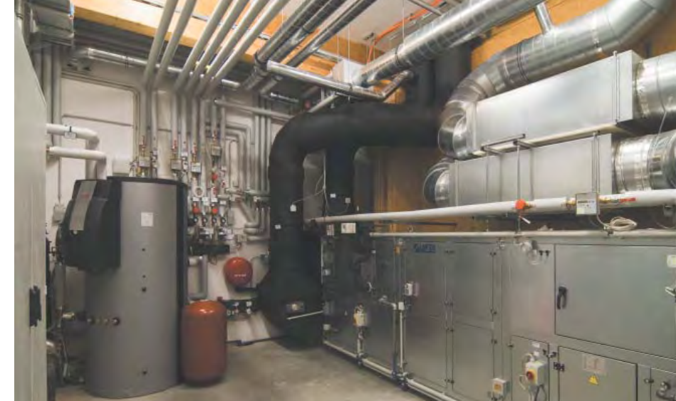
Lüftungswärmetauscher, Technikraum | Ventilation heat exchanger, service room
