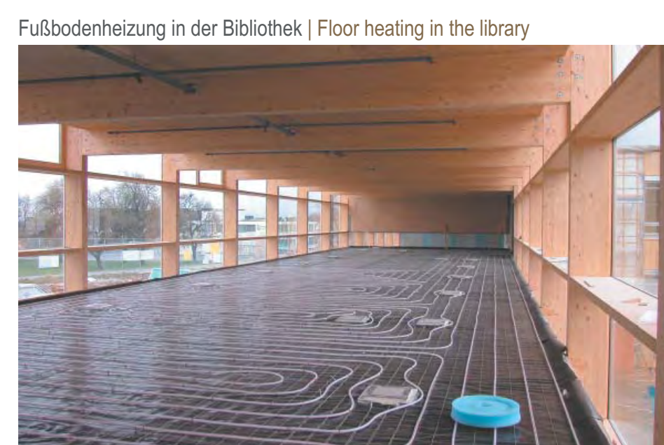
Fußbodenheizung in der Bibliothek | Floor heating in the library
