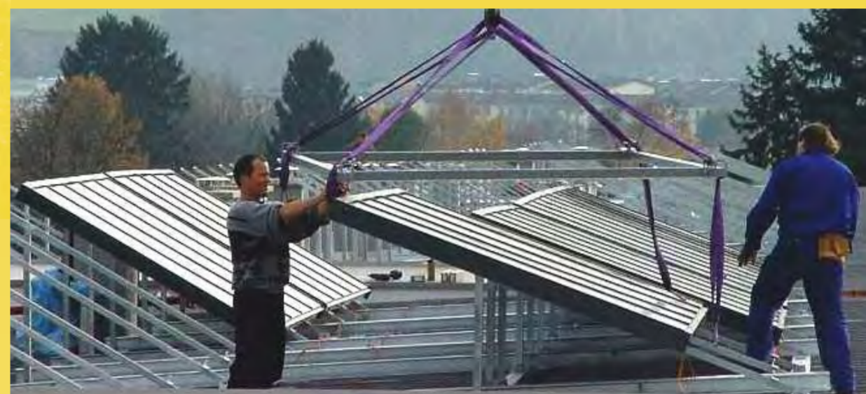
Auf dem Stadtwerkeareal entsteht Salzburgs größte thermische Solaranlage.
