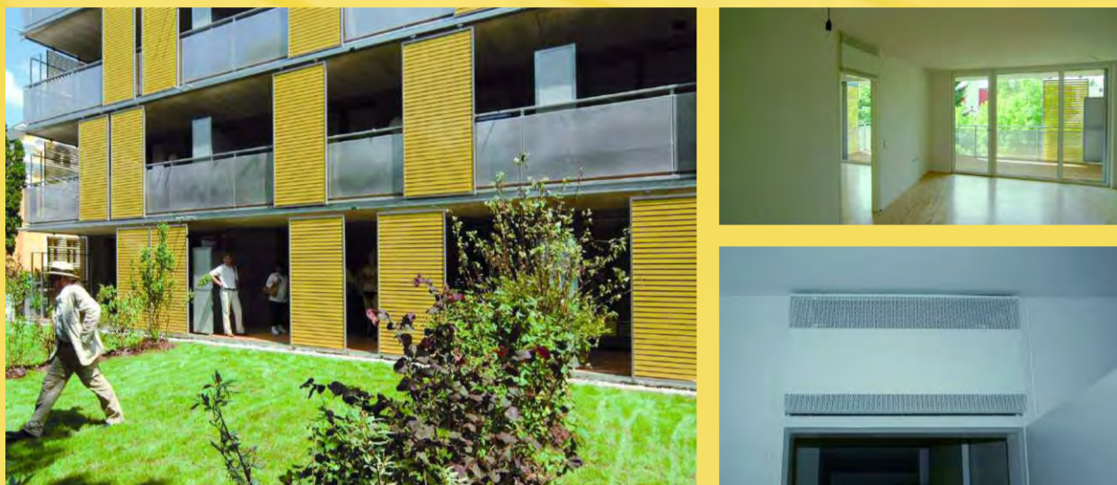
Warmwasserkonvektoren oberhalb der Wohnzimmertüren erwärmen die angesaugte Frischluft. Temperatur und Luftmenge sind individuell regelbar.
