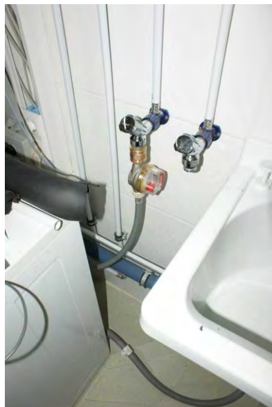
Abbildung 3.13: Installierter Wasserzähler zur Waschmaschine
