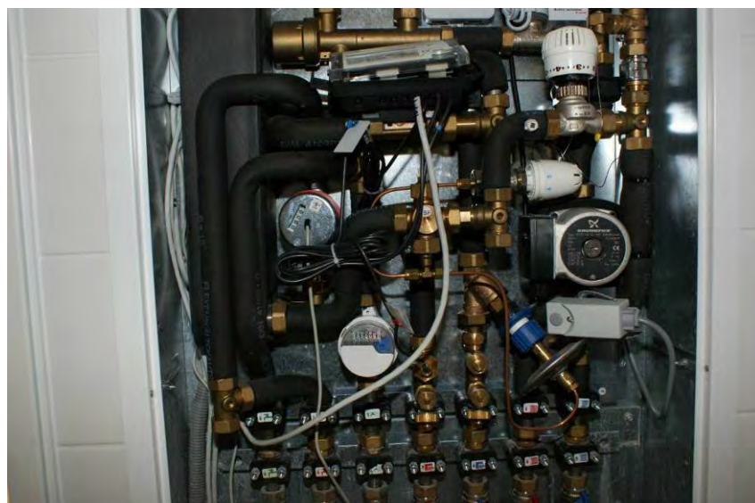
Abbildung 3.27: Wohnungsstation inklusive eingebauter Messtechnik (Wärmemengenzähler, Kalt- und Warmwasserzähler) in allen Wohneinheiten
