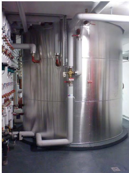
Abbildung 11: Zylindertank mit Apparaturen im Keller
