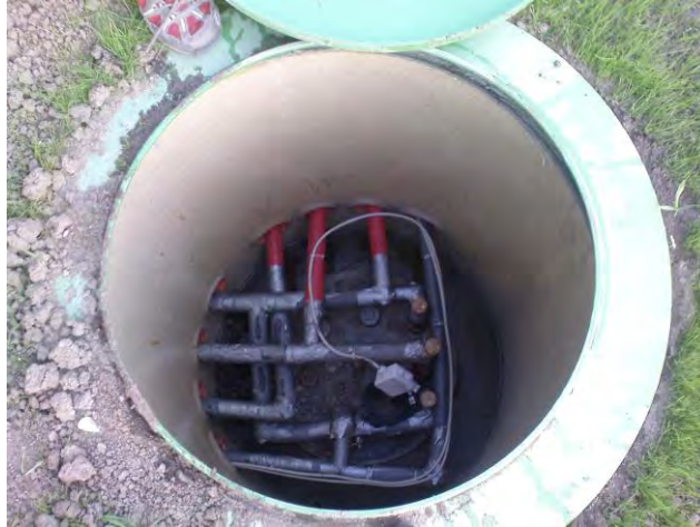
Abbildung 14: Umsteuerungsventile im Domschacht eines Kugeltanks
