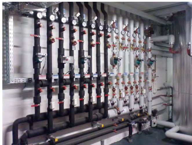
Abbildung 47: Installationsführungen im Keller
