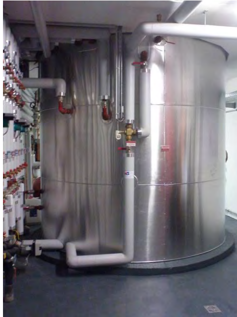
Abbildung 46: Stahltank im Keller
