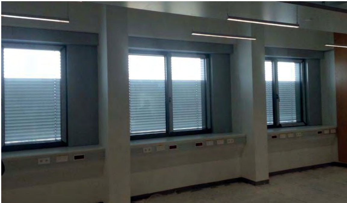
Abbildung 64: Raffstore, unten geschlossen, oben horizontale Stellung (Foto: Schöberl & Pöll GmbH)
