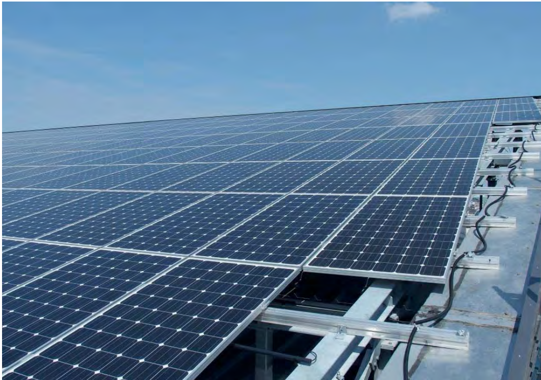
Abbildung 81: Fotovoltaikanlage am Dach (Foto: Schöberl & Pöll GmbH)
