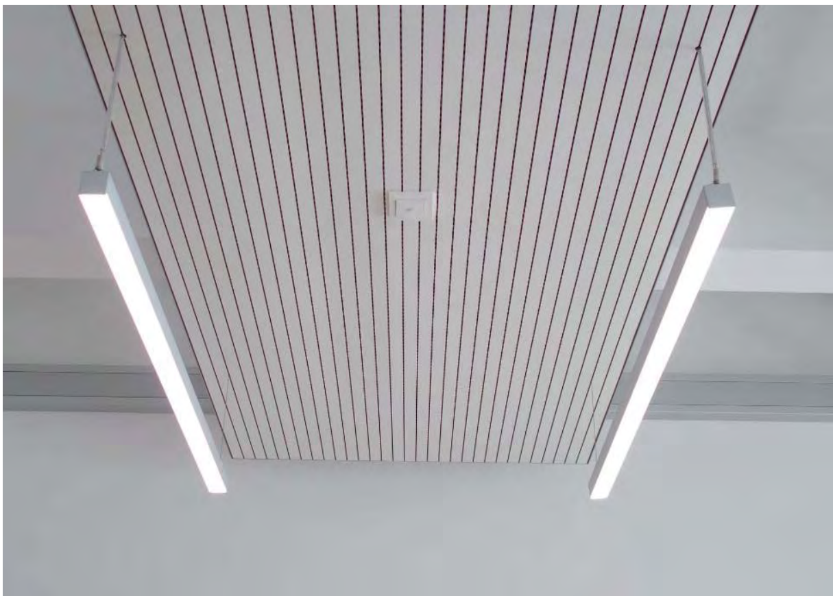
Abbildung 63: LED-Deckenleuchten mit Bewegungsmelder am Akustiksegel im Plus-Energie-Bürogebäude (Foto: Schöberl & Pöll GmbH)
