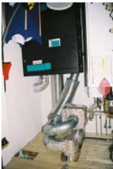
Abb. 47: So sollte der Technikraum nicht aussehen
