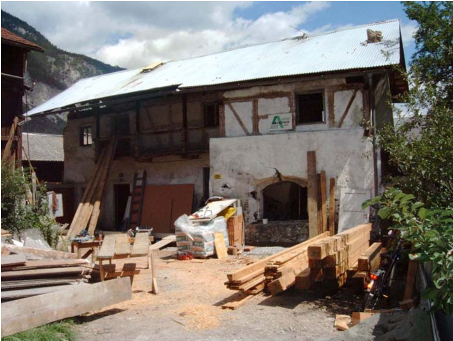
Zustand zu Sanierungsbeginn
