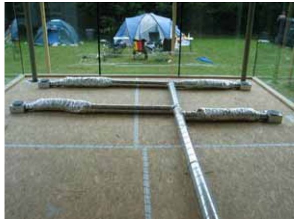
Abbildung 21 – Provisorisch verlegte Lüftungsrohre
