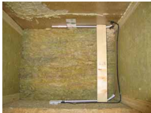
Abbildung 124 – Eingebaute Temperatur- und Feuchtesensoren sowie Taupunkt-detektor
