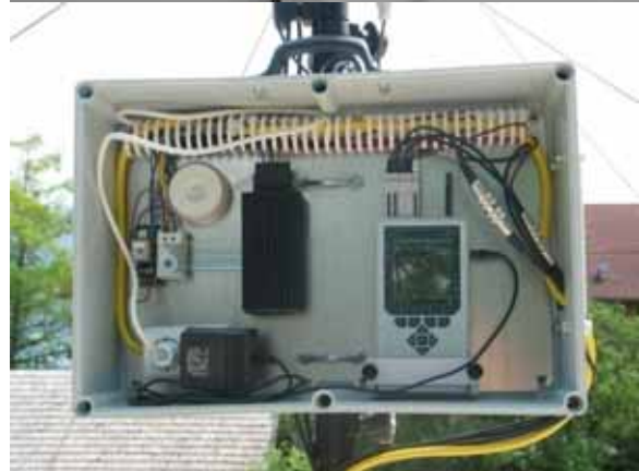
Abbildung 38 – Detailansicht des Datenloggers und des Schutzgehäuses der Wetterstation
