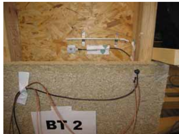
Abbildung 69 – Eingebauter Taupunkt-detektor und kombinierter Temperatur und Feuchtesensor in der Ansicht mit Kabelführung
