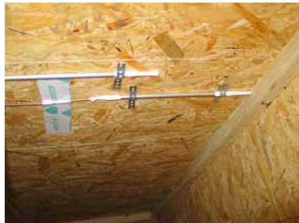
Abbildung 144 – Eingebaute Temperatur- und Feuchtesensoren sowie Taupunkt-detektor
