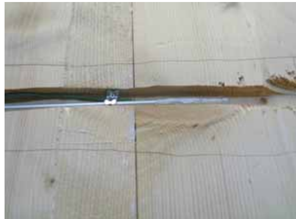
Abbildung 79 – Eingebauter Taupunkt-detektor und Temperaturfühler
