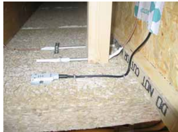
Abbildung 115 – Eingebaute Temperatur- und Feuchtesensoren sowie Taupunkt-detektor
