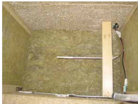
Abbildung 106 – Eingebaute Temperatur- und Feuchtesensoren sowie Taupunkt-detektor
