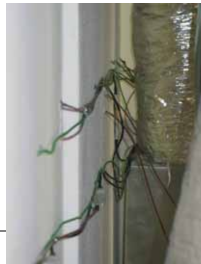
Abbildung 33 - Kabelführung an der Innenseite der Westwand
