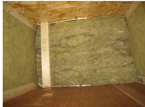
Abbildung 134 – Eingebaute Temperatur- und Feuchtesensoren sowie Taupunkt-detektor
