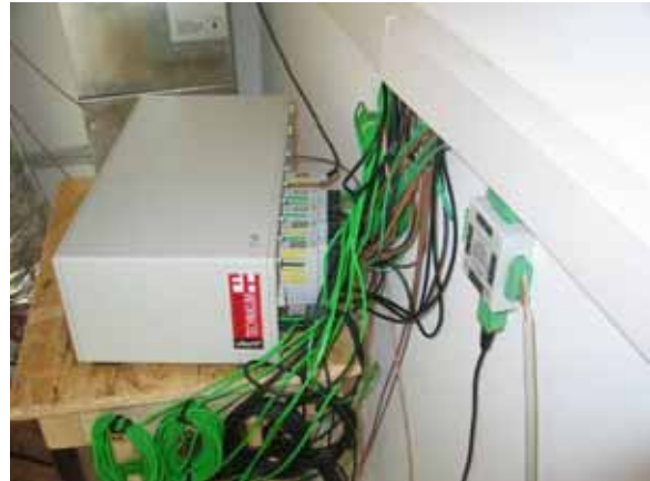
Abbildung 23 - Nahaufnahme eines Datenloggers
