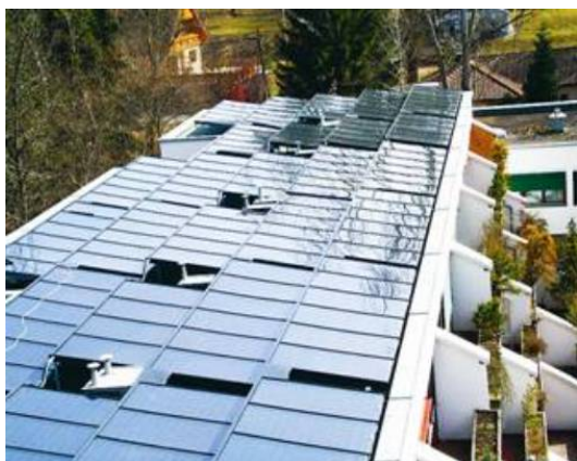
Abbildung 6: Eine nachträglich am Flachdach der Grazer Wohnanlage in der Hans-Riehl installierte Solaranlage mit 320 m 2 speist in das zentrale Warmwasserbereitungssystem (Bildquelle S.O.L.I.D.).
