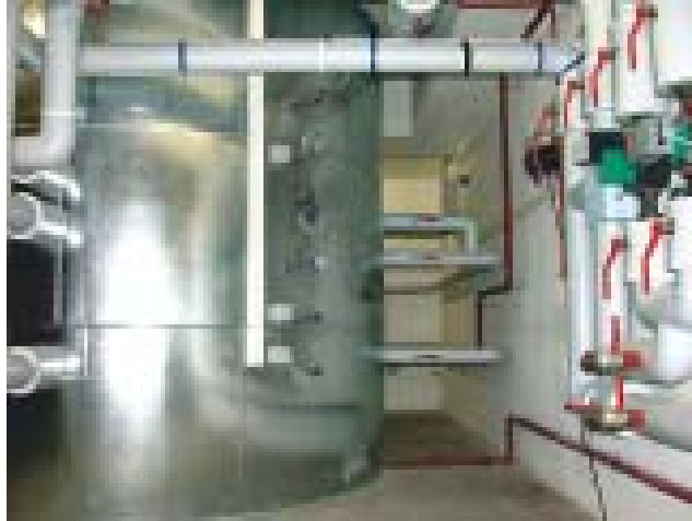
Abbildung 12: Einspeichersysteme reduzieren Kosten und Wärmeverluste entscheidend
