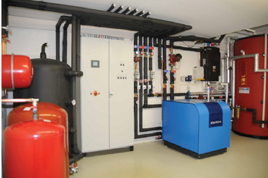
Abbildung 8 SC+ Anlage von SOLution mit einer SorTech Adsorptionskältemaschine mit 7,5 kW Nennkälteleistung (Quelle: SOLution)
