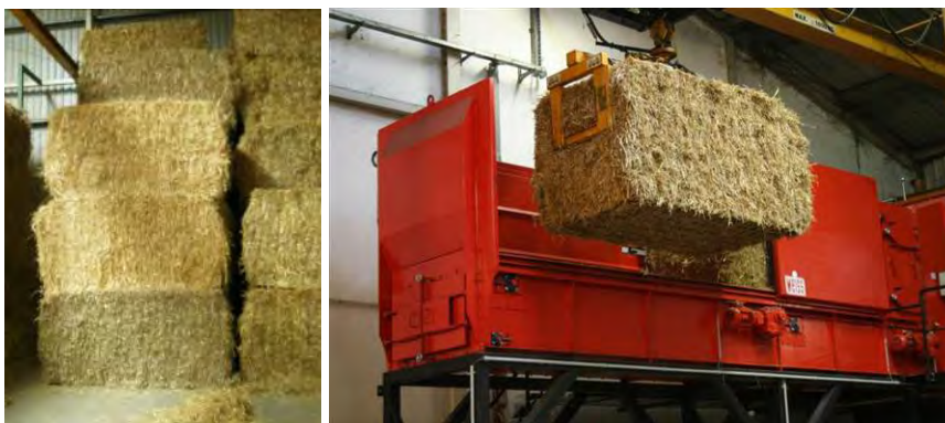
Abbildung 22: Heizwerk Lasee; links: Lagerung von Stroh-Großballen; rechts: Zuführeinheit des Heizwerks: Die Bestückung erfolgt mithilfe eines Krans
