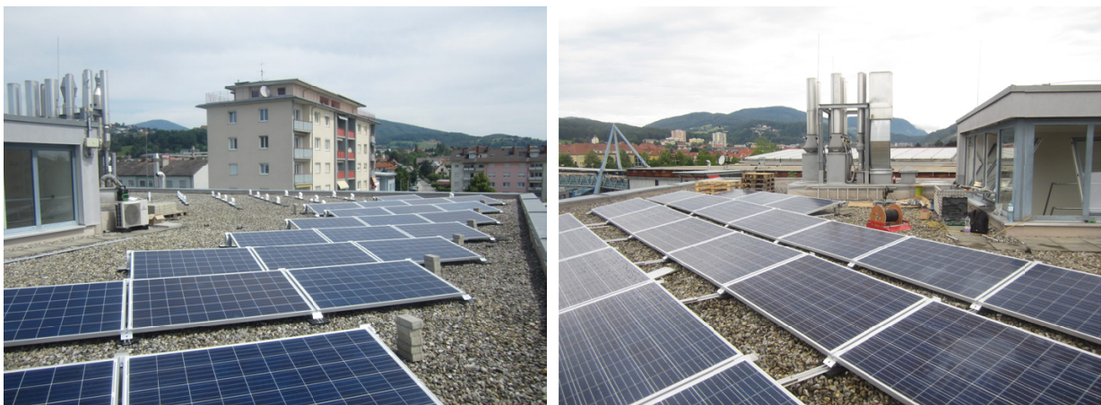
Abbildung 6: PV-Anlage am Dach des W.E.I.Z. II
