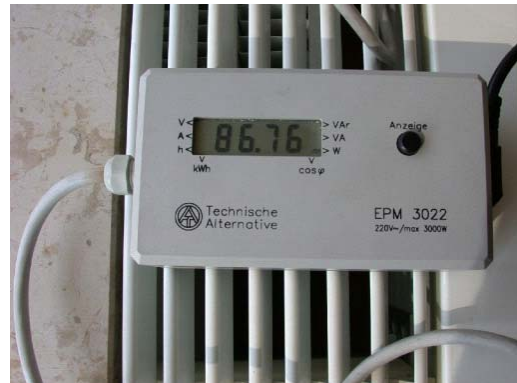
Abbildung 106: Verwendete Leistungsmessgeräte bei der Bestandsaufnahme
