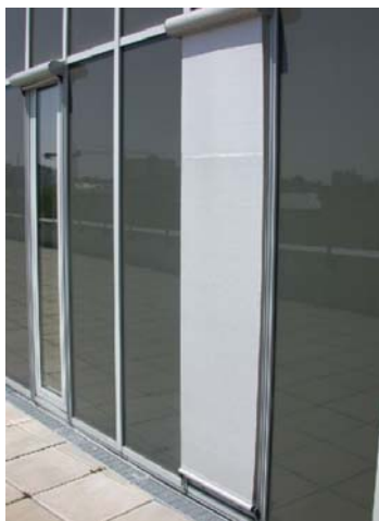
Abbildung 175: Derzeit installiertes Verschattungssystem (grauer Stoffscreen) beim Zubau (5. und 6.OG) des OLG Linz
