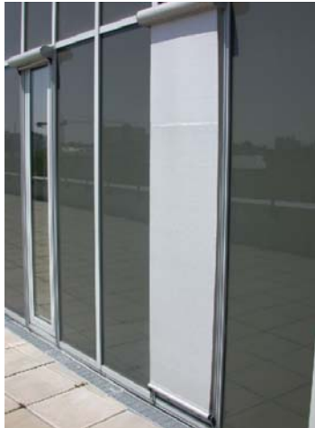
Abbildung 167: Außenansicht des derzeitigen Verschattungssystems (grauer Stoffscreen) im 5. OG des OLG Linz
