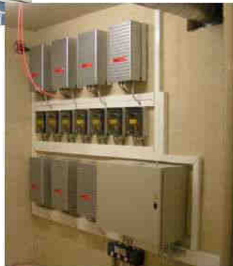
Technikraum mit Sunways NT-Wechselrichter
