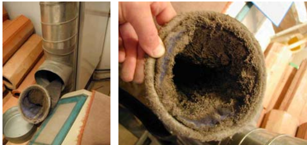
Abbildung 3.103 a-b: Verschmutzte Ventilfilter in Taschenfilterausführung
