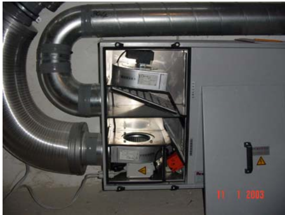
Abbildung 8.3: Ventilatoreinheit des Lüftungsgerätes (REWA)
