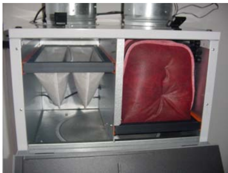
Abbildung 3.98: Vorbildliche Taschenfiltern auf der Zu- und Abluftseite
