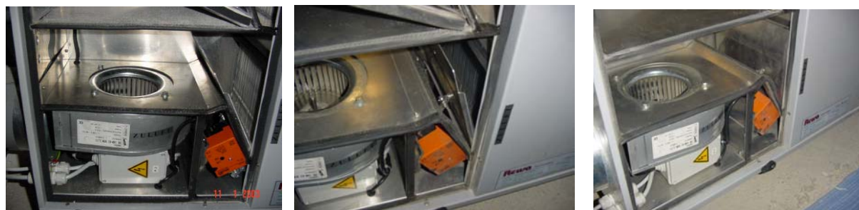
Abbildung 3.105 a-c: Automatische Bypassklappe: geschlossen – halboffen - offen
