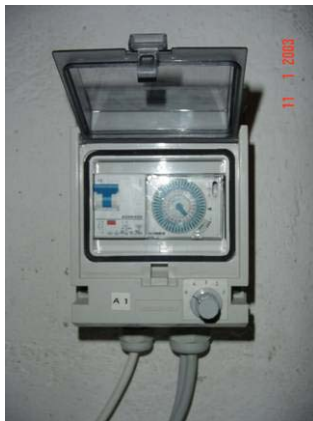
Abbildung 8.15: Steuereinheit im Keller mit eigenem Hauptschalter drei Stufen und Zeitschaltung. (Gerät gibt es auch mit BUS-gesteuerter Regelung und Filterwechselanzeige).
