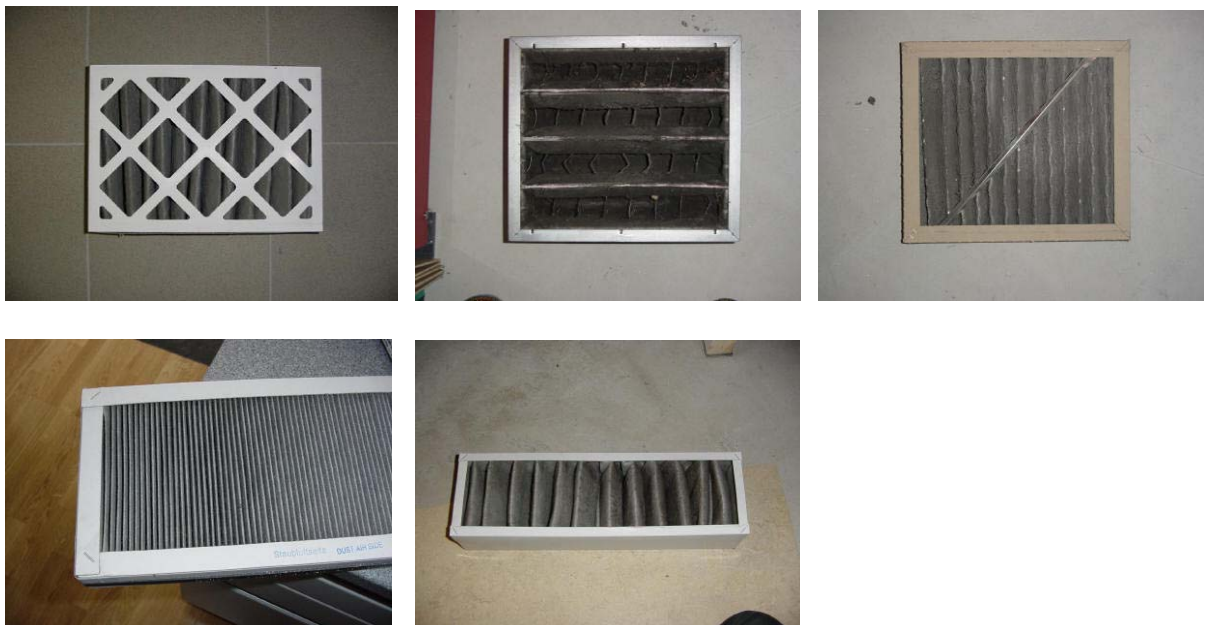
Abbildung 3.101 a-f: Verschmutzte Kassettenfilter
