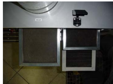
Abbildung 3.99: Lüftungsgerät mit einer Kombination aus Matten- und Kassettenfilter im Zuluftbereich (rechter Bereich) sowie einem einfachen Mattenfilter in Abluftbereich (linker Bereich)
