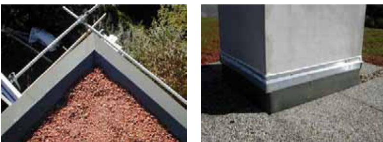
Abb. 174 Hochzüge mit ausreichender Höhe aber unzureichendem Schutz gegen mechanische Beschädigung
