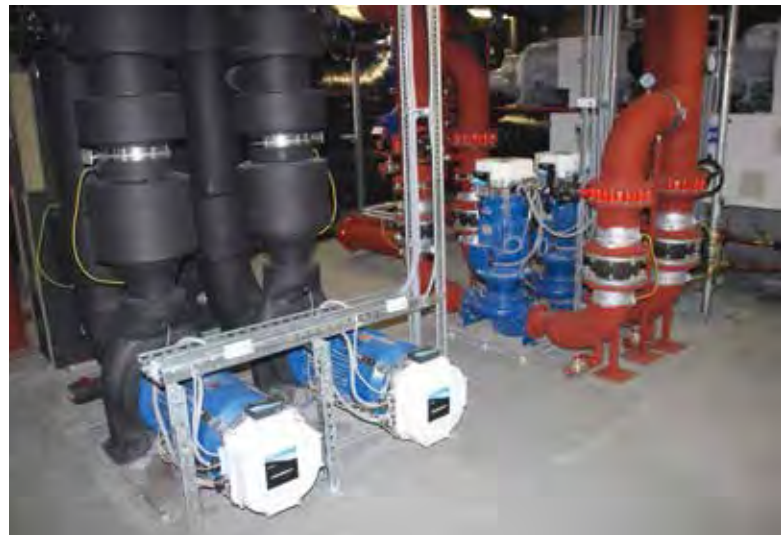
Heiz- und Kältemaschinen (oben) wie auch eine Umwälzpumpe für Kälte sorgen in Kombination mit Wärmepumpen für eine angenehme Atmosphäre auf dem gesamten Campus WU.
