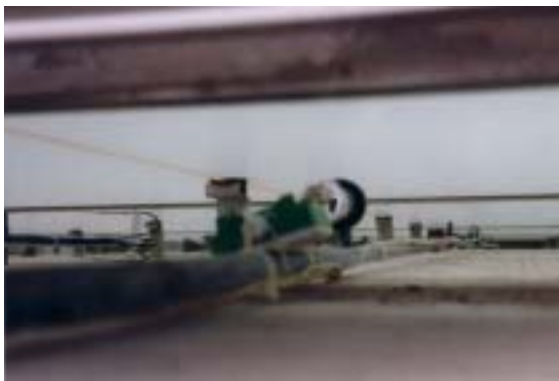
Abb. A1 Temperatur- und Feuchtemessfühler des Messfalls „Wand“
