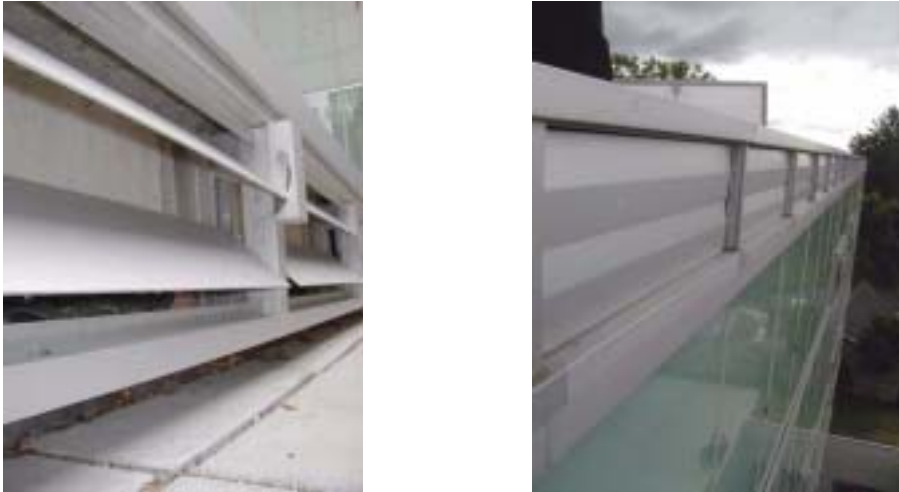
Abb. 43 Lüftungsklappen am Eintritt, maximale Öffnung (links) und am Austritt, geschlossen (rechts)
