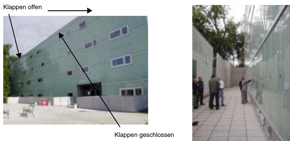
Abb. 112 Ansicht Südfassade mit oberen (links) und unteren Lüftungsklappen (rechts)
