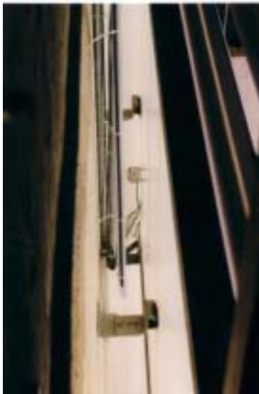
Abb. A5 Strahlungsmessgeräte im Fassadenzwischenraum
