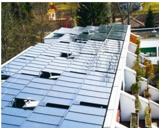
Abbildung 20: Eine nachträglich am Flachdach der Grazer Wohnanlage in der Hans-Riehl installierte Solaranlage mit 320 m 2 speist in das zentrale Warmwasserbereitungssystem (Bildquelle S.O.L.I.D.).
