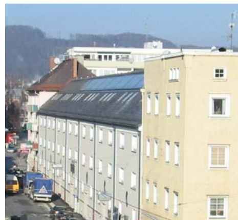
Abbildung 21: Im Zuge einer umfassenden Modernisierung wurde in der Salzburger Plainstraße (42 Wohneinheiten) vom Wohnbauträger gswb eine Solaranlage mit 164 m 2 Kollektorfläche in Verbindung mit einem Wärmeversorgungskonzept nach dem Prinzip von „Zwei-Leiter-Netzen“ und Wohnungsstationen umgesetzt (Bildquelle: gswb)
