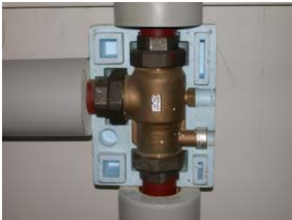
Abbildung 17: Beimischeinrichtung mit Fixtemperatureinstellung ohne Fremdenergie (Bildquelle: AEE INTEC)
