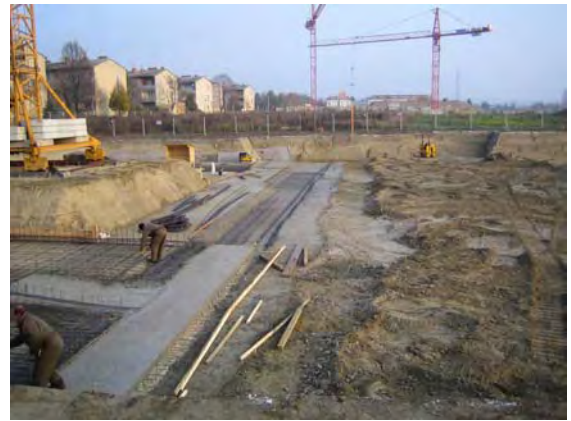
09.11.2005: Baugrube Haus A und B sowie Tiefgarage, Sauberkeitsschicht, bewehren und betonieren der Bodenplatte
