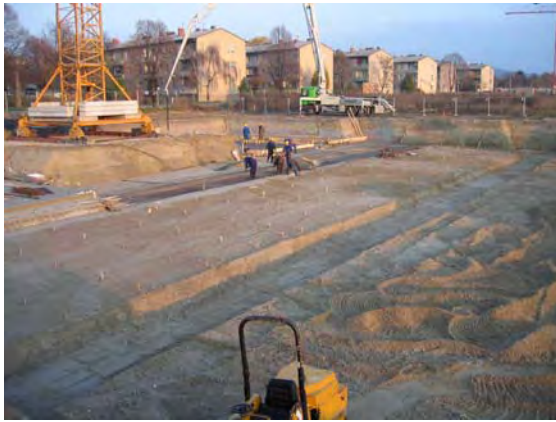
11.11.2005: Baugrube Tiefgarage, Herstellen des Niveaus, Sauberkeitsschicht, bewehren der Streifenfundamente für die Säulen der Tiefgarage
