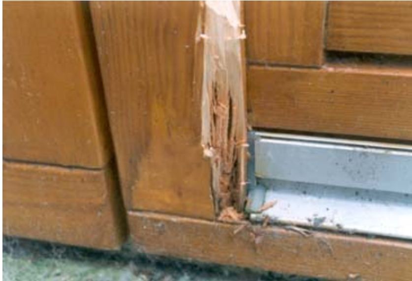
Abb. 15: Fenster mit Bläuebefall (Pilz) aufgrund von Spritzwassereinwirkung [Quelle: http://www.holzfragen.de/seiten/fenster.html , Abgerufen am 27.11.2007]
