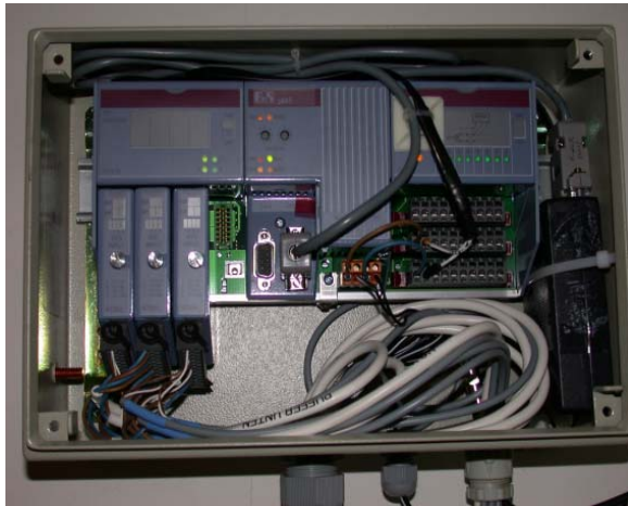
Abbildung 24: Ansicht des fertig verdrahteten Datenloggers
