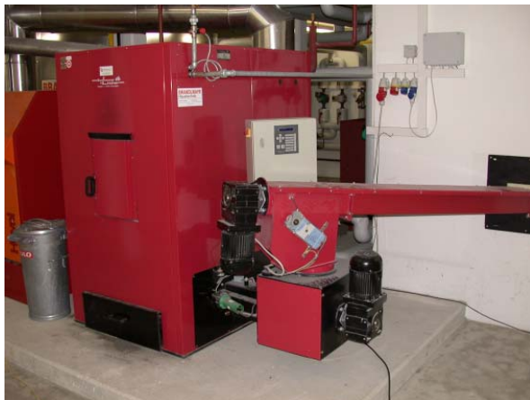
Abbildung 19: Pelletskessel zur Grundlastabdeckung
