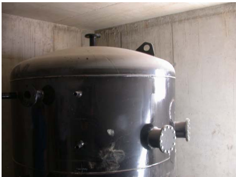
Abbildung 41: Anordnung des 8 m 3 fassenden Energiespeichers im teilweise abgesenkten Fundament des Heizhauses
