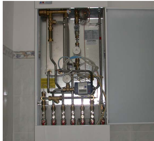
Abbildung 25: Ansicht einer installierten Wohnungsstation inkl. Wärmemengenzähler
