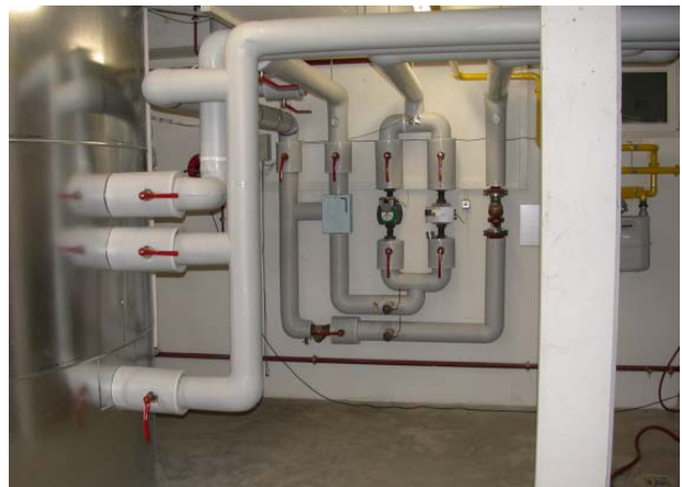
Abbildung 20: Detail zu Rohrführung und Dämmstandard im Heizhaus
