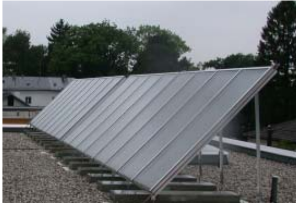
Abbildung 21: Anordnung der Kollektoren am Flachdach
