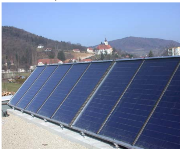
Abbildung 29: Ansicht der am Flachdach positionierten Kollektoranlage
