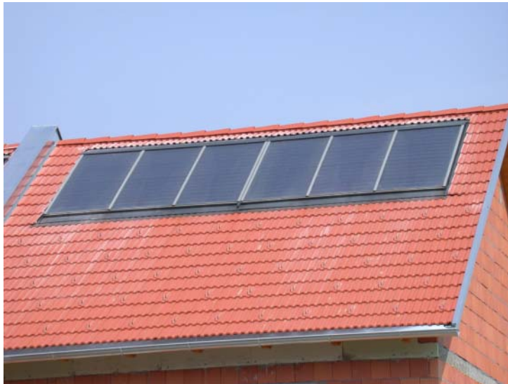
Abbildung 34: Detailansicht – Dachintegration eines Kollektorfeldes
