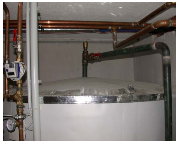
Abbildung 30: Detailansicht aus dem Heizhaus – der Energiespeicher ist bereits gedämmt, die Rohrleitungen sind noch ungedämmt.
