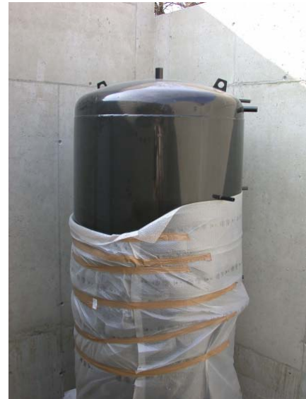
Abbildung 35: Detailansicht aus dem externen Heizhaus – Positionierung des Energiespeichers
