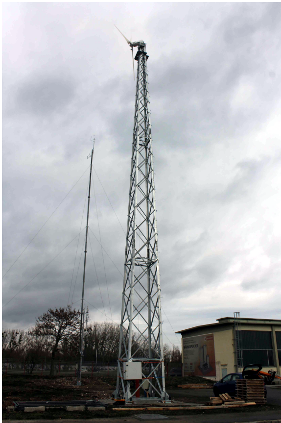
Abbildung 49: KWEA Schachner SW5 im Kraftwerkspark Simmering (Quelle: Eigene Darstellung)
